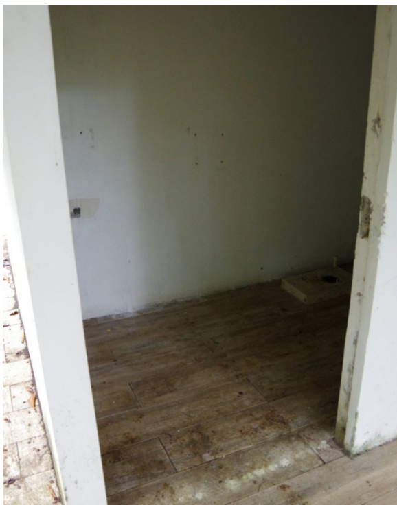
Robo de puerta y Servicio Sanitario
