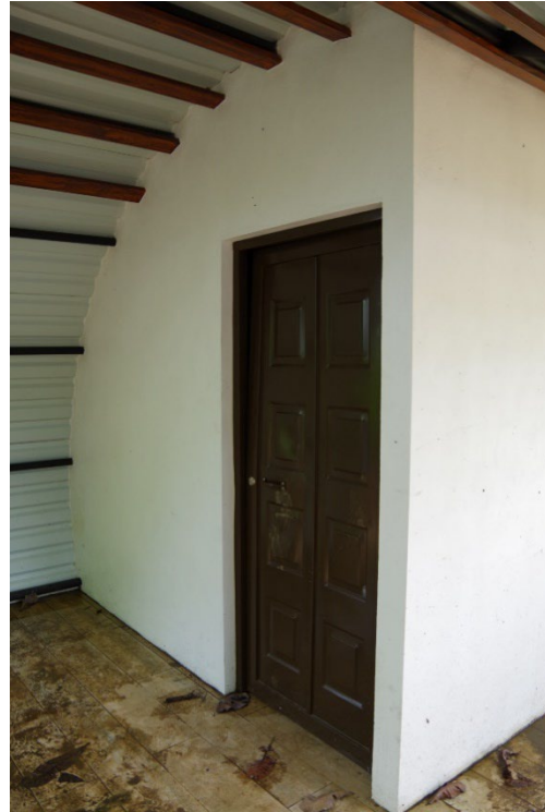
Daños materiales por intento robo
